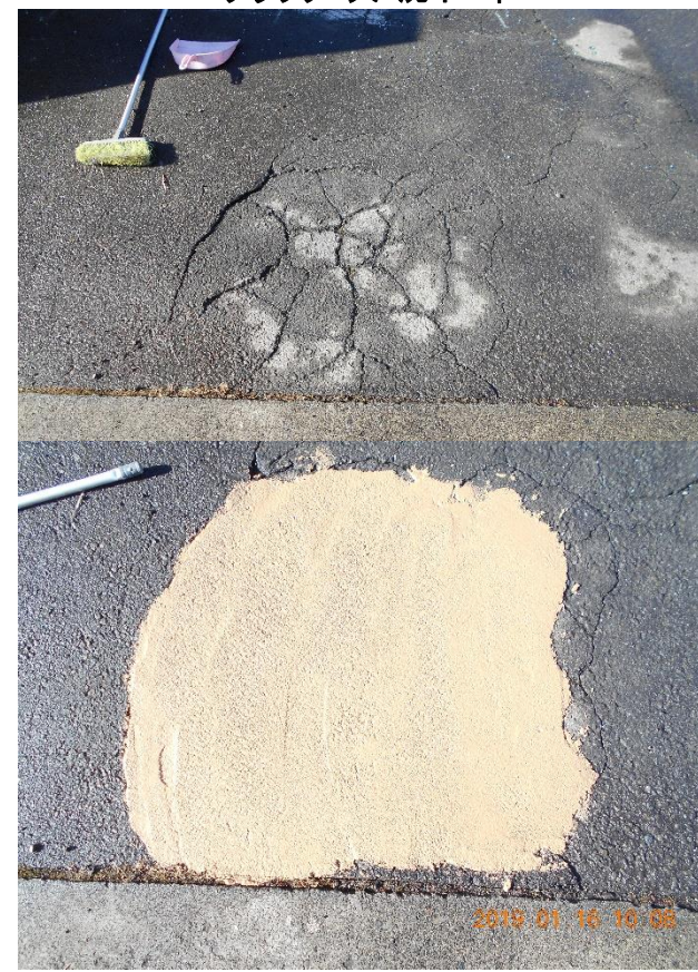
クラック 大・沈下 中
