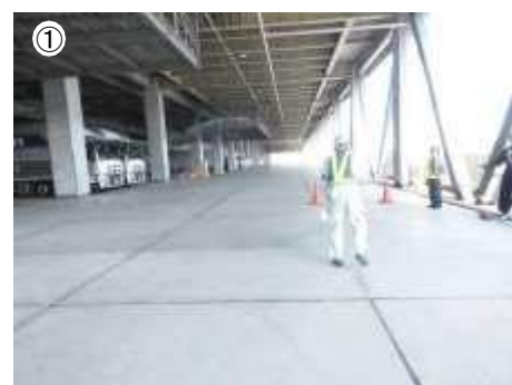
施工前：目地端部のクラック
