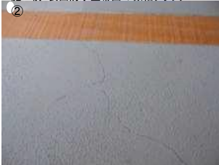
施工前：表面防水塗膜面の微細クラック
