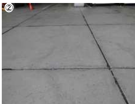
施工前：目地材抜けとRC端部欠けが発生
